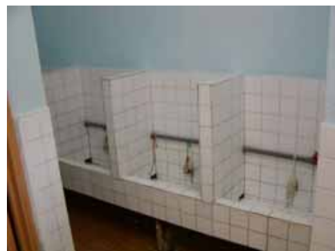
男子用小便器 上級公衆トイレにて
